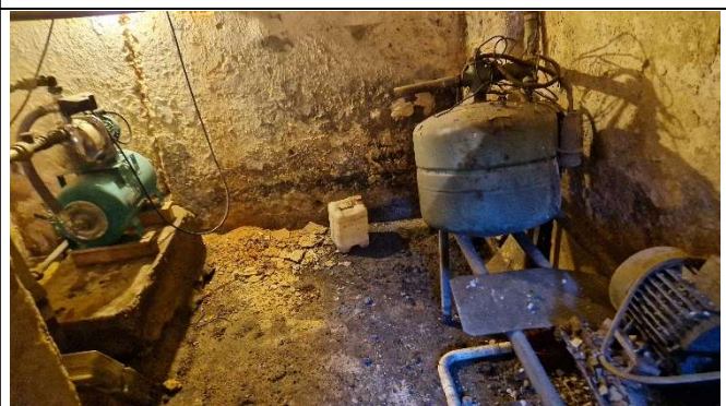
Vodovod – studniční čerpadlo a domácí vodárna v suterénu
