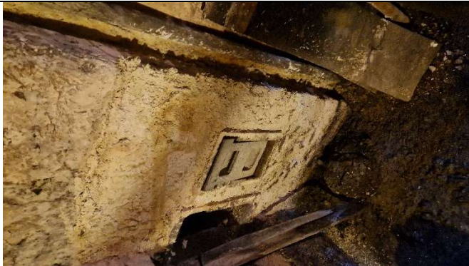
Suterén- zdivo i omítky degradovány vlhkostí
