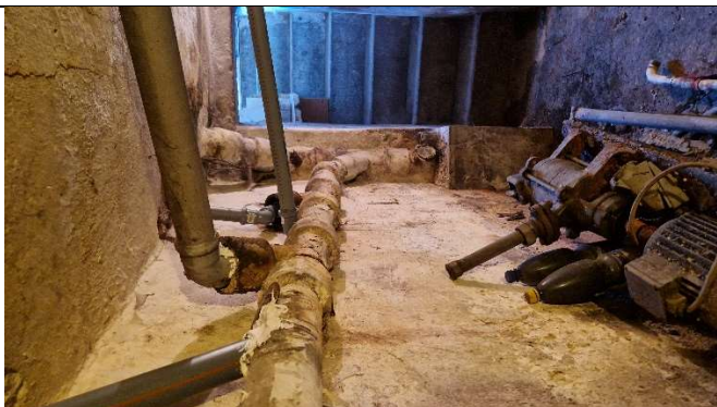
Suterén- prostor schodiště-zdivo i omítky degradovány vlhkostí
