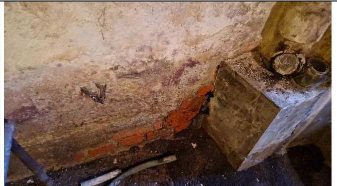
Suterén- prostor pod schody-zdivo i omítky degradovány vlhkostí
