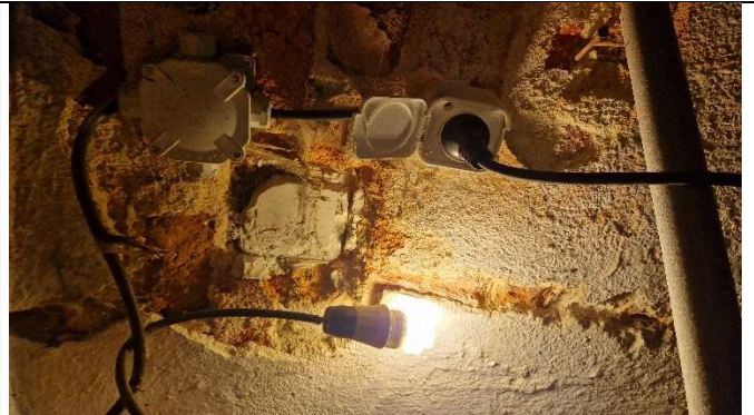
Suterén- zdivo i omítky degradovány vlhkostí
