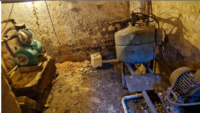
Suterén- zdivo i omítky degradovány vlhkostí
