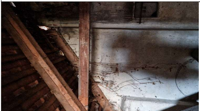
Půda - pohled na střechu a SZ štítovou stěnu s netěsným oplechováním
