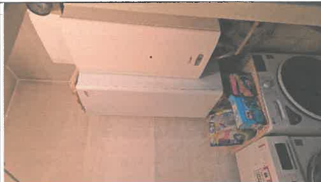
Technické zařízení – kotel na zemní plyn-kotelna v přízemí
