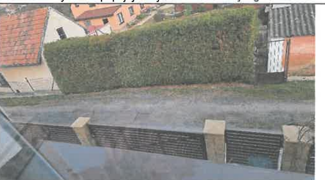
Kanalizace – obecní pozemek před domem, ve kterém je kanalizace vedena, v pozemku je patrný poklop původní kanalizační jímky
