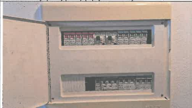
Elektro -domovní rozvaděč s jističi v garáži v přízemí
